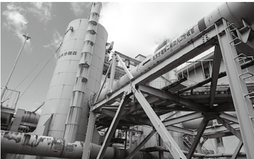
取り出した高温の地下水を蒸気と熱水に分離する気水分離器
