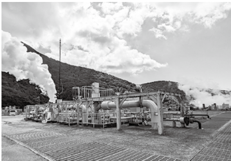
地下深部から熱水と蒸気を取り出すための井戸、 蒸気井
