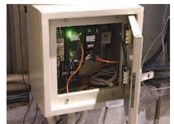
工場内の設備稼働状況をIoTで見える化
